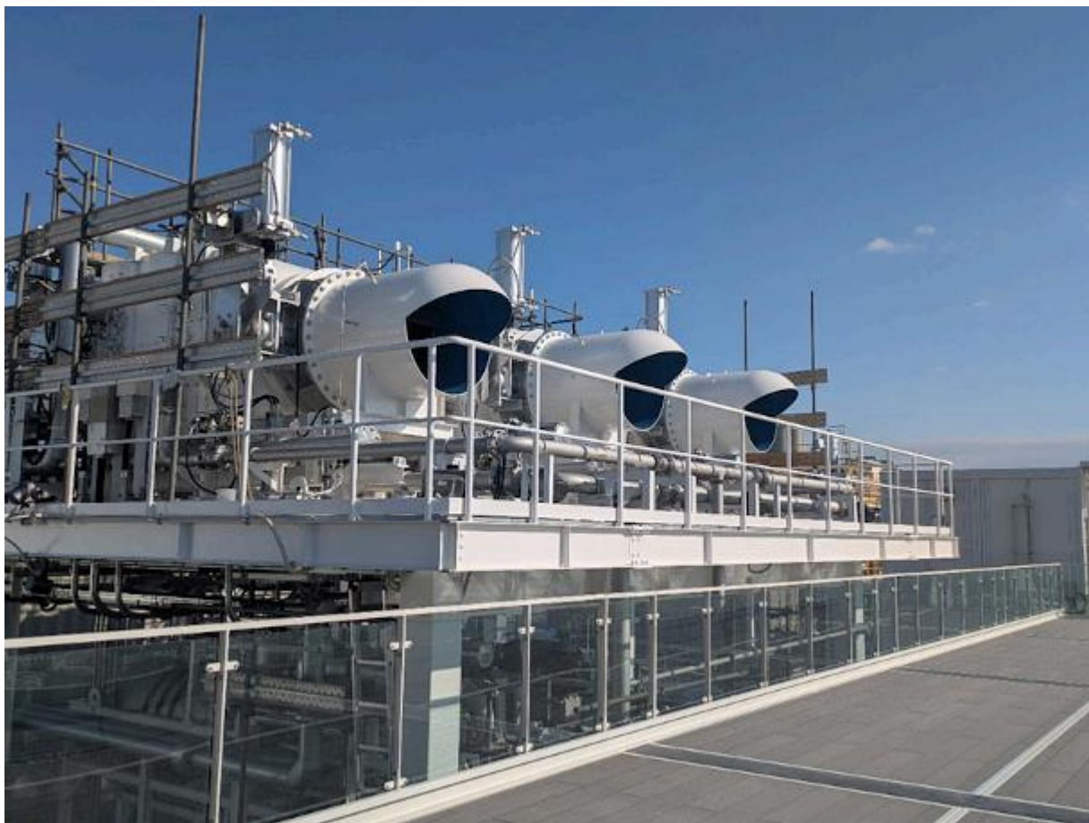
2024年12月26日撮影 DAC実証プラント
