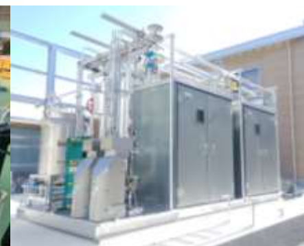
ボイラユニット
