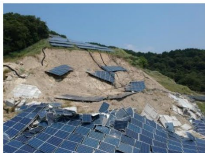
土砂崩れで生じた崩落
