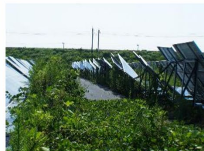
不十分な管理で放置されたパネル
